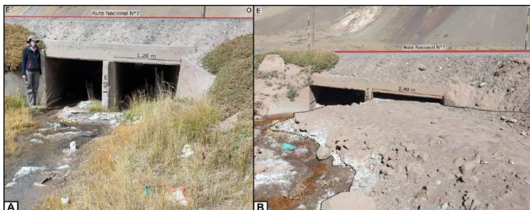
Figura 9. a. Drenaje del abanico occidental, (quebrada Las Leñas). Fotografía tomada en abril de 2019. b. Drenaje parcialmente colmatado del abanico de la quebrada Agua Salada. Fotografía tomada en abril de 2019.
